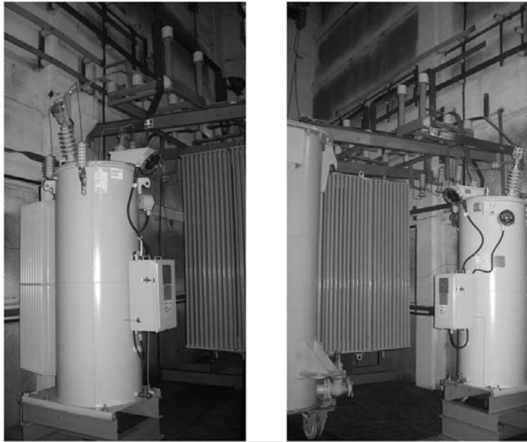
Рис. 7. Установка ПАРН в ячейке трансформатора (слева вольтодобавочный трансформатор-1, справа вольтодобавочный трансформатор 2)
