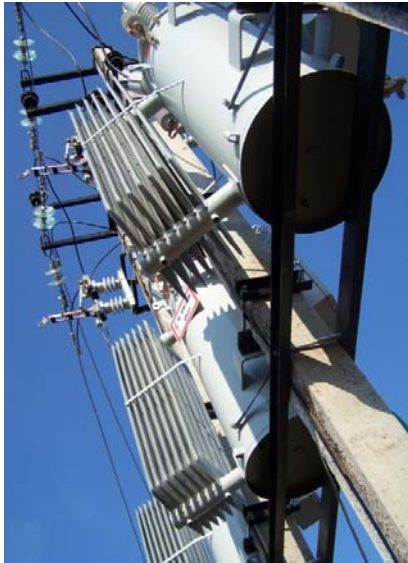
Рис. 1. Пункт автоматического регулирования напряжения
